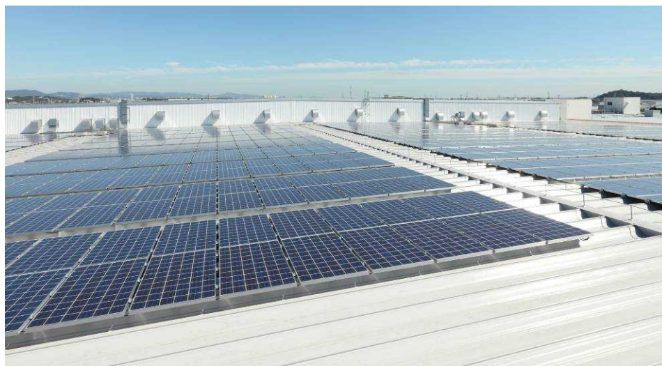
(屋根に設置したソーラーパネル)
